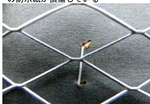
写真-5 ステープルの周辺部の防水紙の損傷
